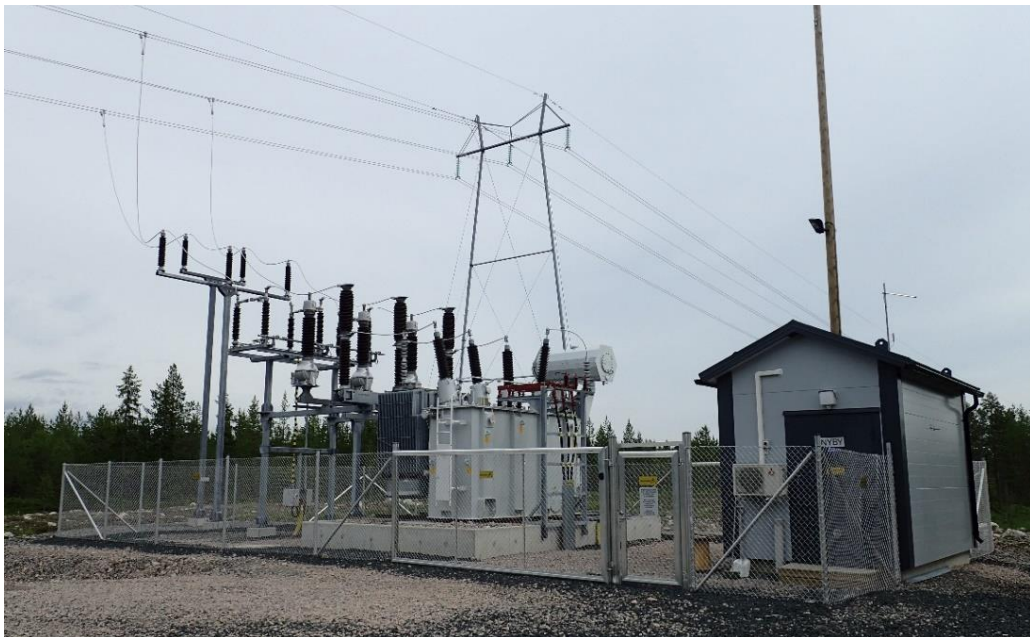
Kuva 20. Esimerkki tuulivoimapuiston sähköasemasta.
