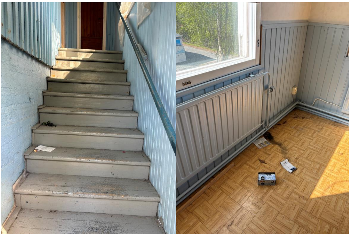
Portaikun runko pettänyt. Patteriverkosto vuotanut useammasta kohdasta.
