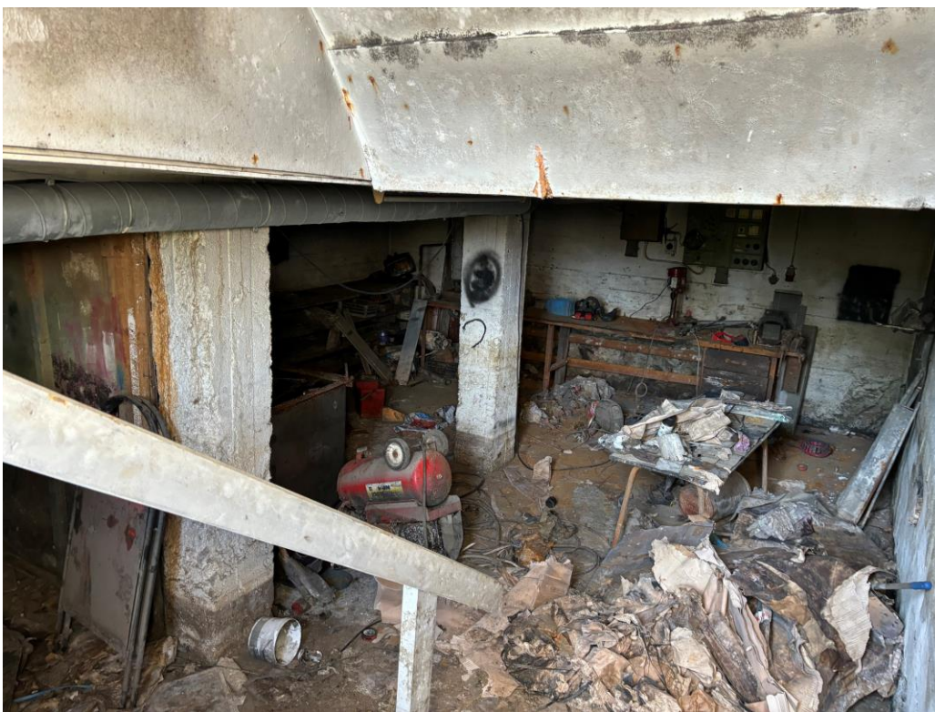
Tulva noussut kellariin ja jäljistä päätellen kellariin on johtunut vesivuotoja.
