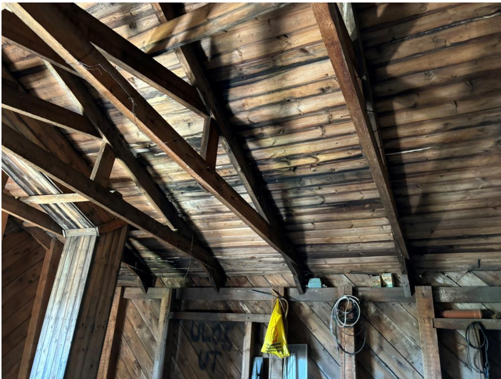
Vesikate vuotanut ja lahottanut kattorakenteita.
