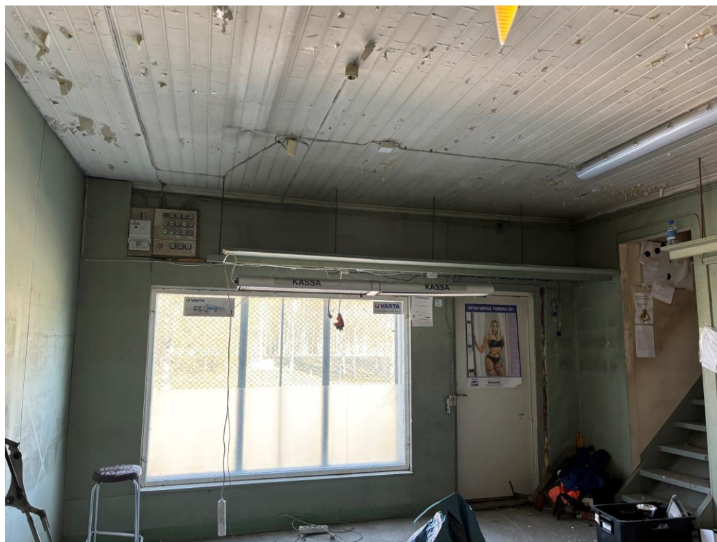
Välikaton kosteus irrottanut maalin katosta.
