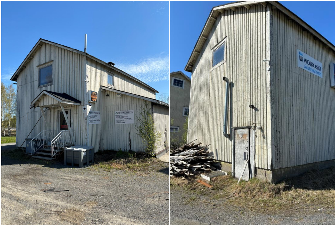
Kattorakenne painunut ja vesikate repeillyt, jonka vuoksi vuotanut.
