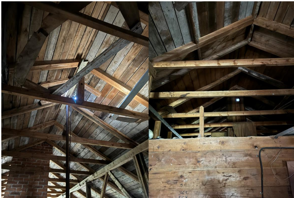
Vesikate on vuotanut ja katossa on reikiä.
