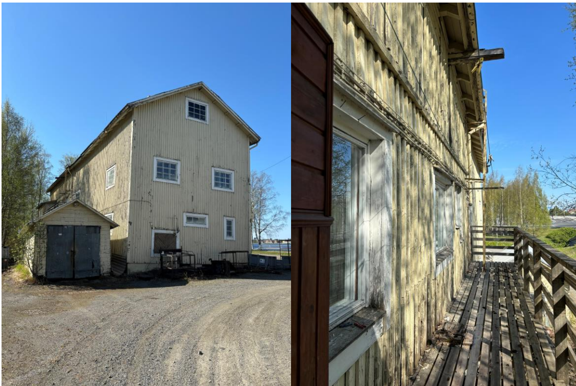
Ulkovuori rapistunut ja lahonnut. Terassi / käyntitaso laho ja vaarallinen.
