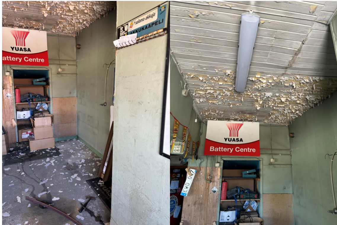
Välikaton kosteus irrottanut maalin katosta.
