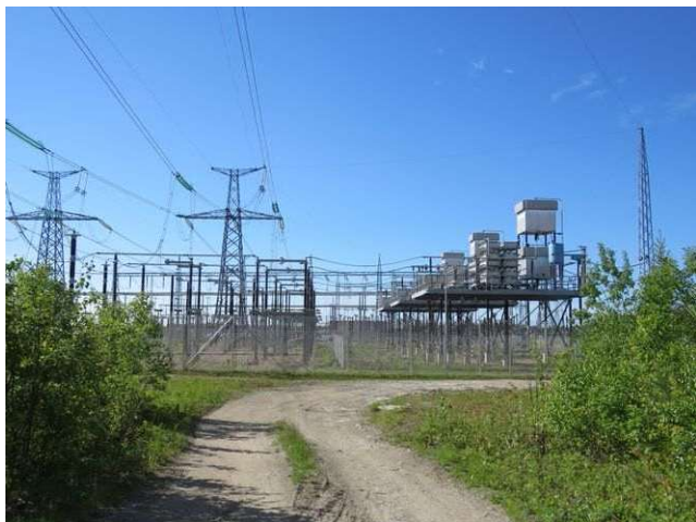
Kuva 45. Keminmaan sähköasema etelään.
