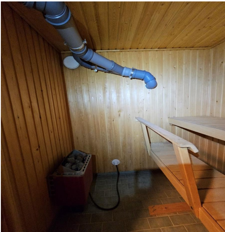
Kuva 55, sauna on poistettu käytöstä, kuljetettu viemäriin saunahuoneen läpi
