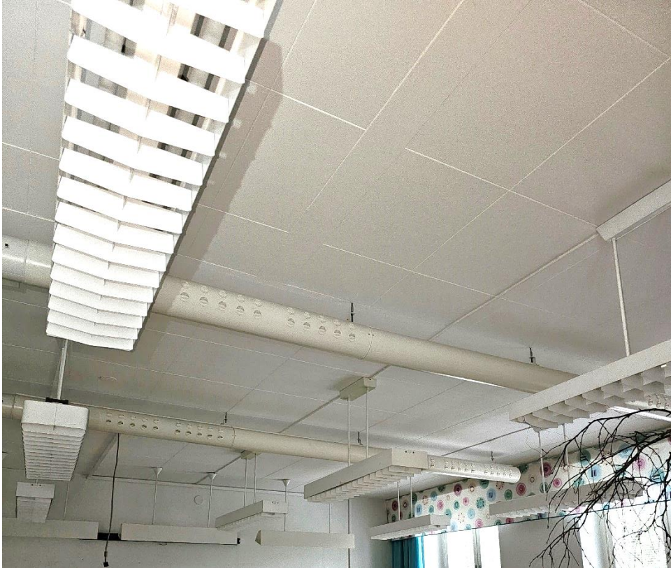
Kuva 65, ilmanvaihdon päätelaitteita, kuvassa myös luokkatilan valaistusta
