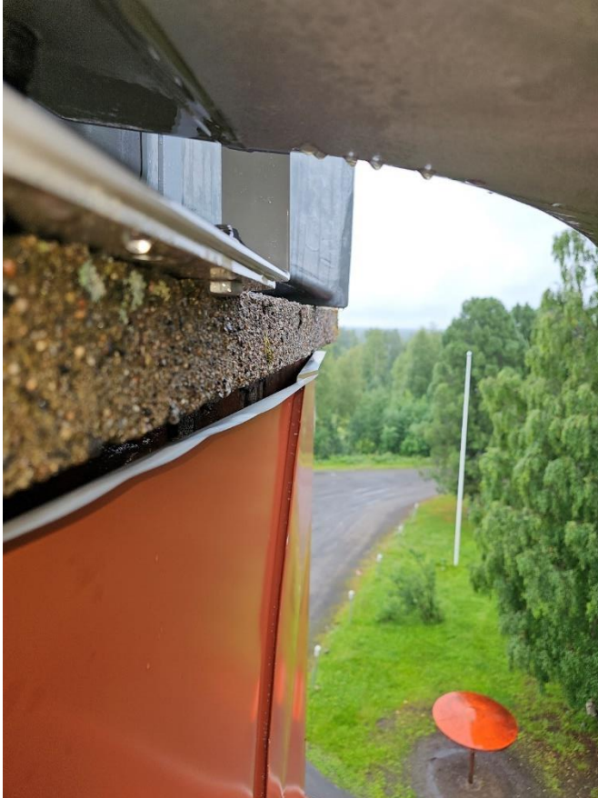
Kuva 40, pellitys on irti piipusta, hatun reunalla ei ole selkeää tippanokkaa
