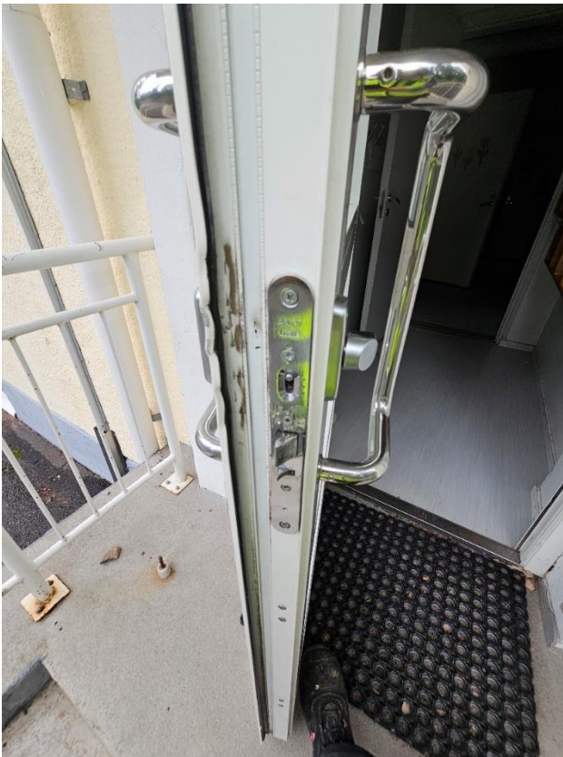
Kuva 23, päädyn ulko-ovessa on mekaanisia vaurioita, ovea on yritetty murtaa
