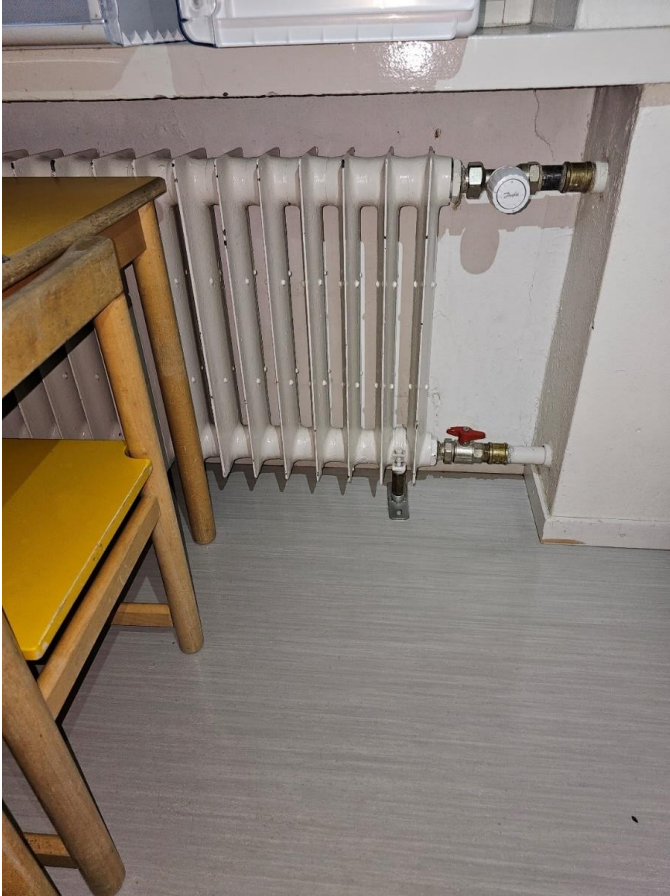
Kuva 54, termostaatit vaihdettu. Tähän asennettu jostain syystä alasäättö nupilla
