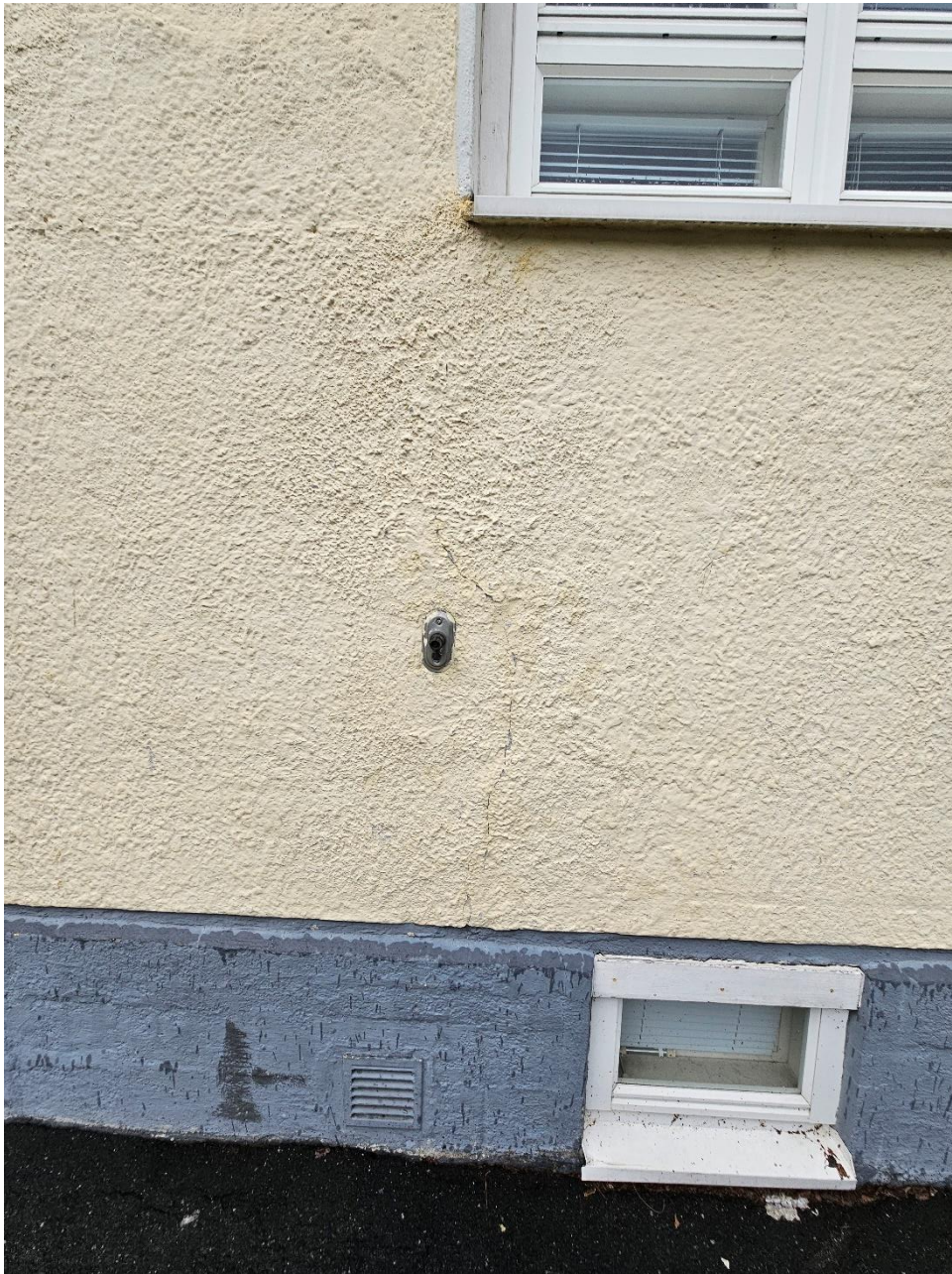
Kuva 20, julkisivua ja sokkelipintaa, halkeama, joka osin avautunut korjaamisen jälkeen
