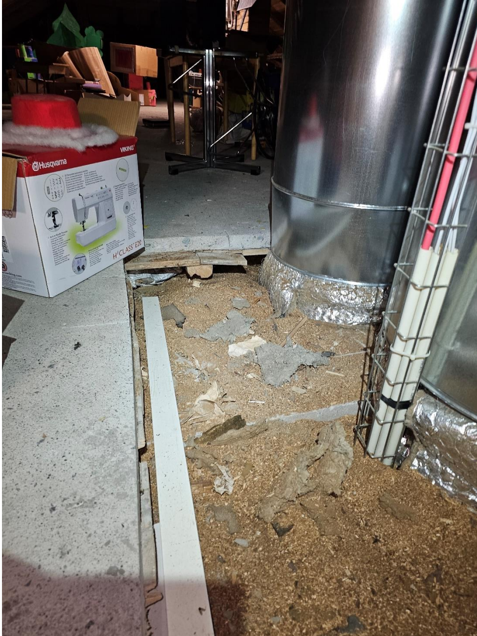
Kuva 17, avattua ullakon palopermanttoa (tod. näk. IV läpimenojen vuoksi). Rakenteessa voidaan arvioida olevan alalaattapalkisto, jossa täytteenä sahanpuru. Pintavalu tehty muottilaudoituksen päälle
