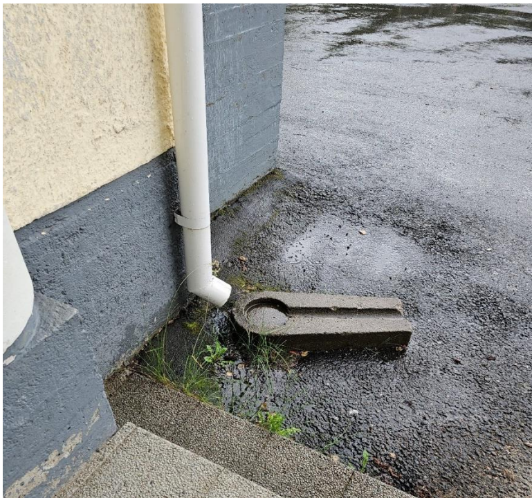
Kuva 2, syöksytorni asfaltilla, loiskekivi siirtynyt paikoiltaan
