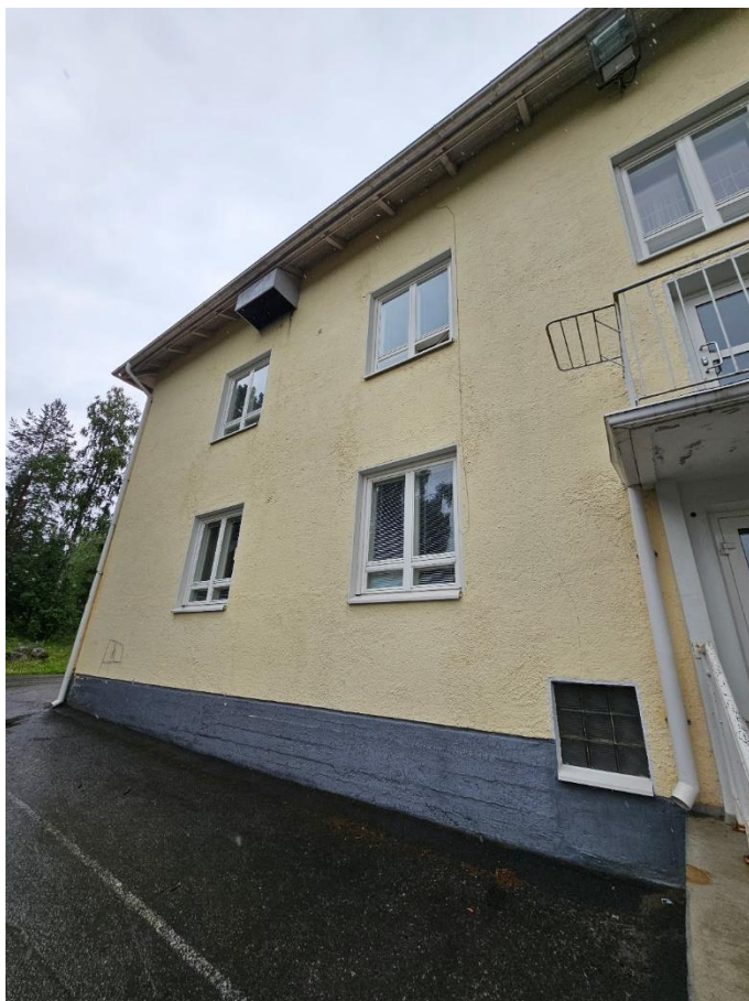
Kuva 10, ikkunoiden sivuilla on pystyhalkeamat. Kyseessä voi olla osin tiilirakenteen kutistumaa, osa halkeamista on korjauksen jälkeen avautunut
