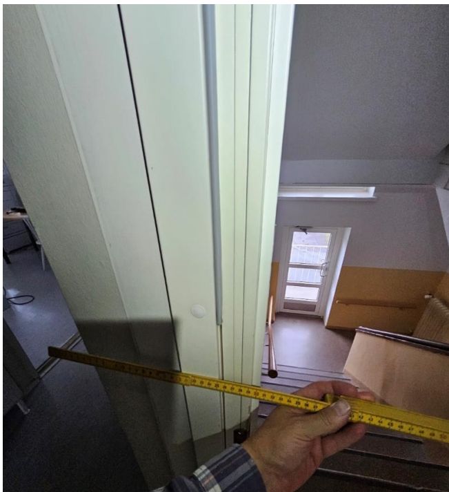
Kuva 14, porrashuoneen sivuseinä 30 cm
