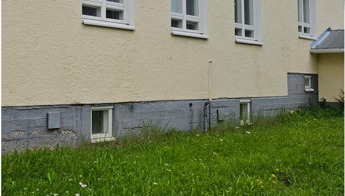
Kuva 50, takaseinustalla on öljysäiliön yhteet
