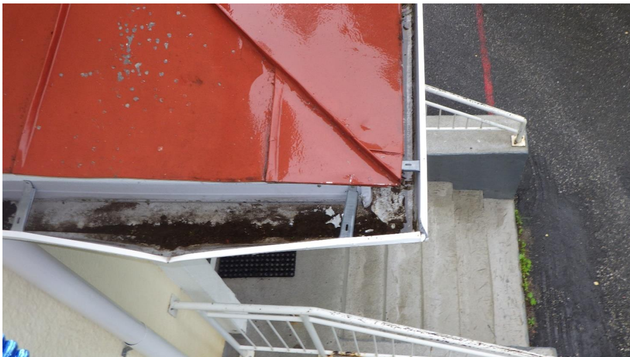
Kuva 37, päädyn sisäänkäyntikatoksen kouru taipunut
