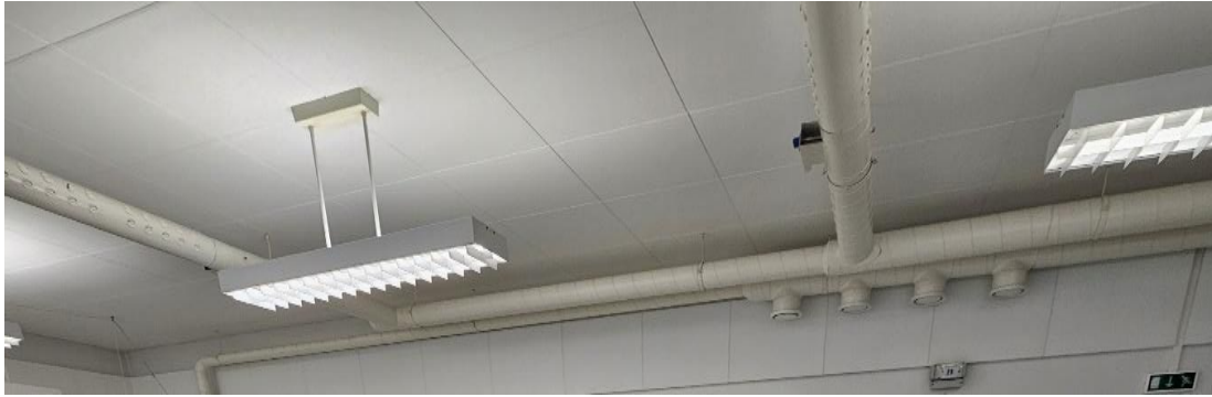
Kuva 64, luokan ilmanvaihtojärjestelmiä, tuloilmaventtiilit katossa ja taustalla poistoilmapäätteet
