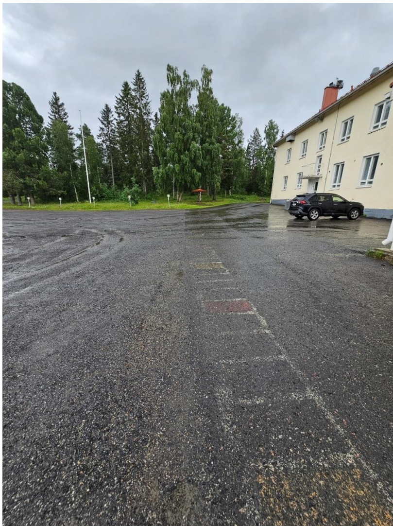
Kuva 3, asfaltoinnin raja kuvan keskellä, taustalla näkyy lämmitystolpat
