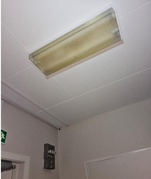
Kuva 73, yhdessä eteisessä vanha loisteputkivalaisin, seinällä myös posliinisulakkein pieni vanha alakeskus, kytkimiseen
