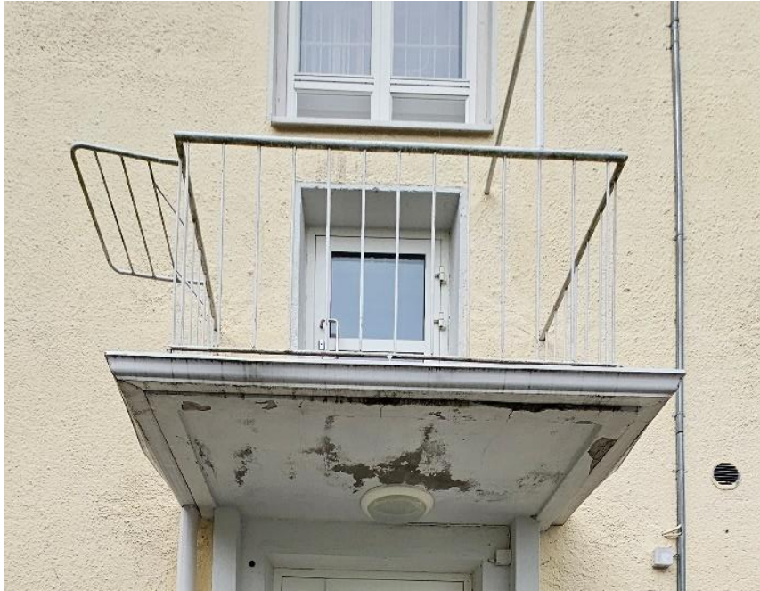
Kuva 27, laatasta alapuolella viitteitä kosteudesta
