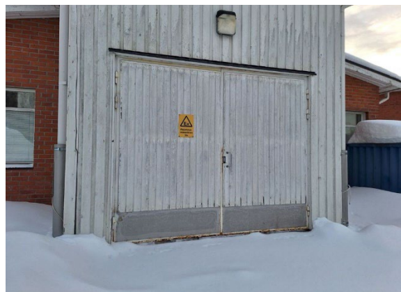
Kuva 17. Puuosissa on maalipintavikoja.
