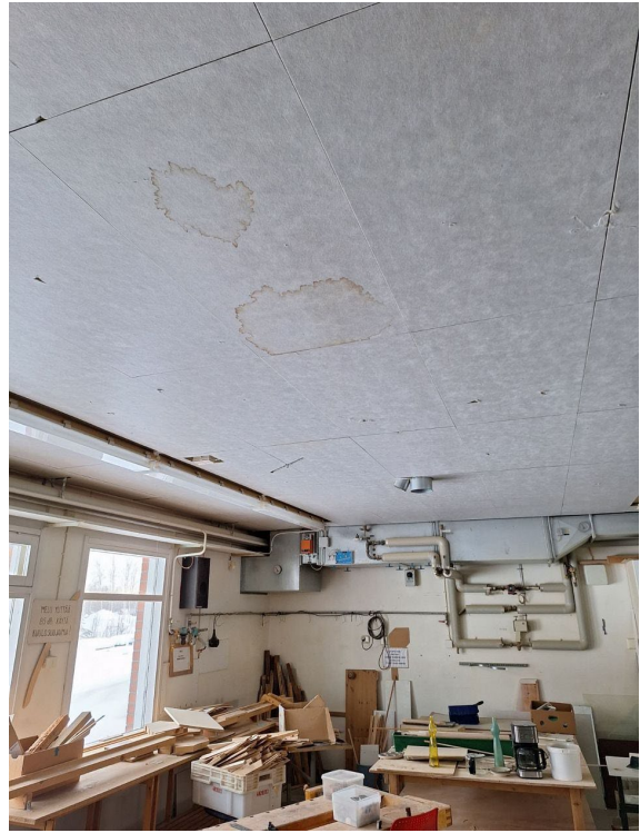
Kuva 64. Puutyösalin katossa on Vanhoja vesivuotojälkiä.
