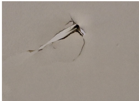
Kuva 62. Ääneneristyslevytyksessä oleva vaurio.
