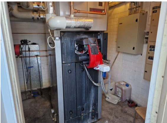
Kuva 75. Öljykattila ja poltin.
