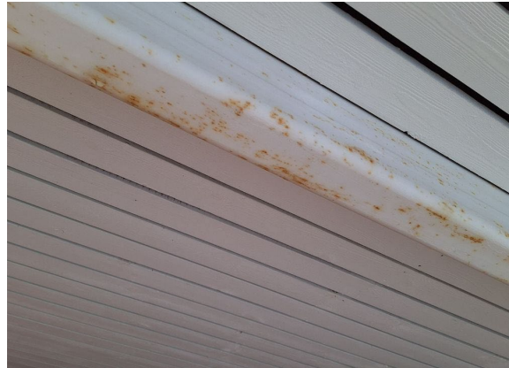
Kuva 45. Ruostevaurioita sisäänkäyntikatoksen teräsosissa.
