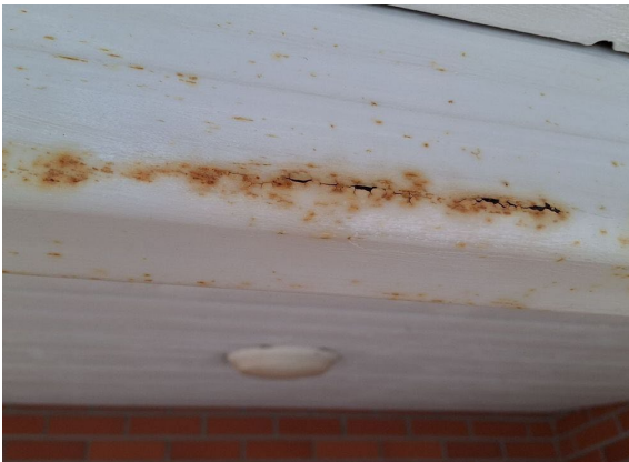
Kuva 46. Ruostevaurioita sisäänkäyntikatoksen teräsosissa.
