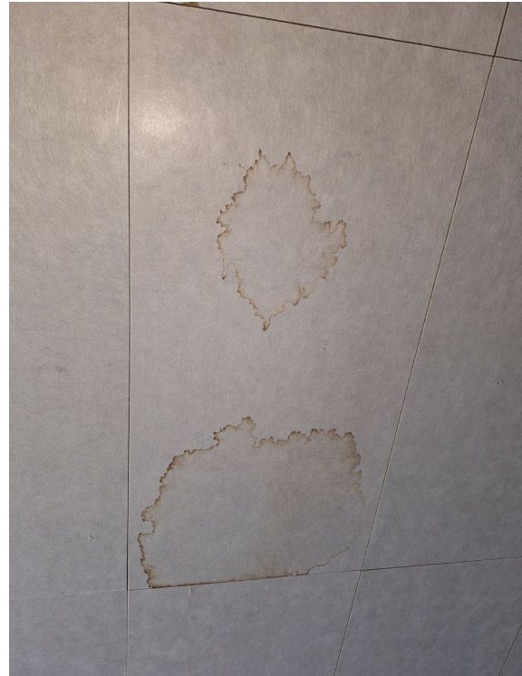
Kuva 66. Sisäverhoiuksissa on vanhoja vesivuotojälkiä
