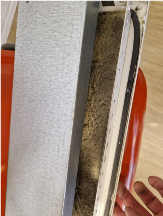
Kuva 105. Tuloilman päätelaitteessa on mineraalivillaa.
