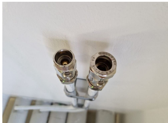
Kuva 90. Käyttövesijohtojen päitä on auki, vesivahinkovaara.
