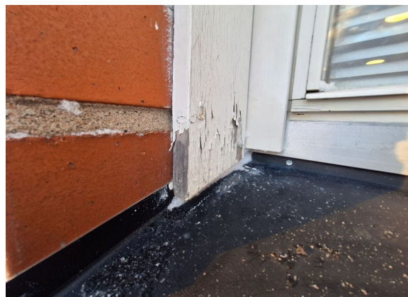
Kuva 19. Hilseilyä ikkunoiden puuosissa.
