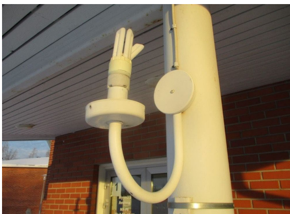
Kuva 146. Rikkinäinen ulkovalaisin ja suojakupu puuttui (tien puolella).
