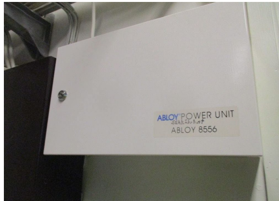
Kuva 170. Sähkölukkojen keskusyksikkö (IV-tilassa).
