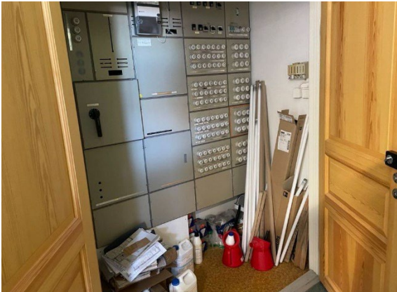
Kuva 116. Pääkeskus näkymää, tavaraa.
