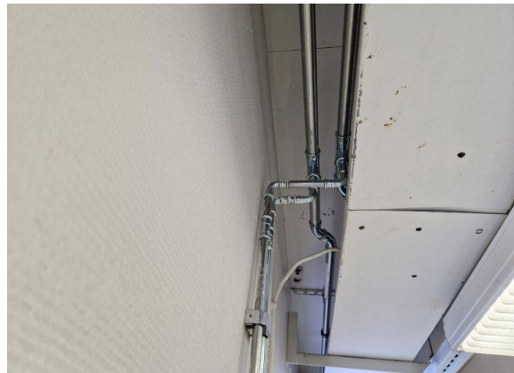
Kuva 80. Uusittuja lämpöjohtoja, eristykset puuttuvat.
