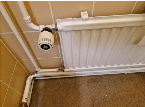
Kuva 84. Patteri, Danfos patteriventtiili ja -termostaatti (vv. 1979-1985).
