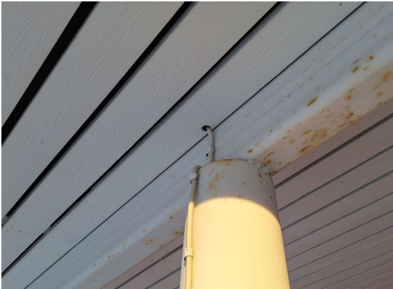
Kuva 44. Ruostevaurioita sisäänkäyntikatoksen teräsosissa.
