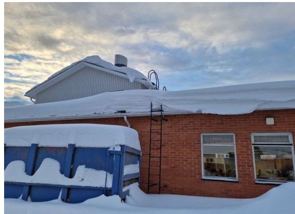
Kuva 101. Katolla ei ollut turvallista käydä.
