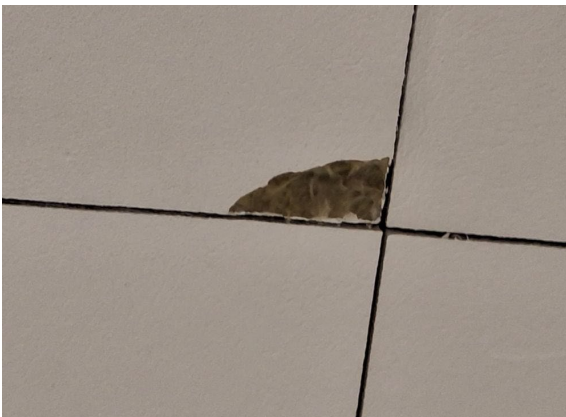
Kuva 61. Ääneneristyslevytyksessä oleva vaurio.
