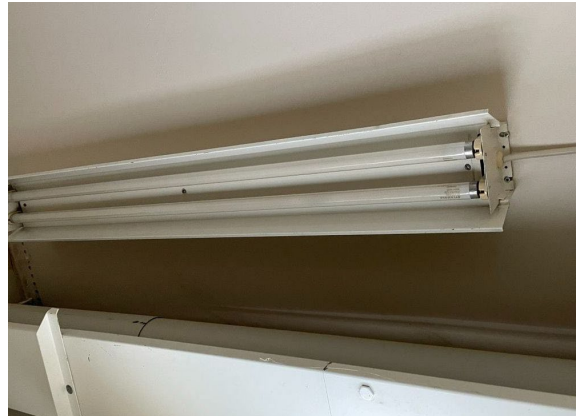
Kuva 141. Vanhempia kuristinloistevalaisimia (T8 putki).
