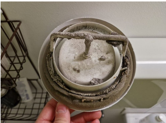
Kuva 107. WC:n poistoilmaventtiili on likainen.
