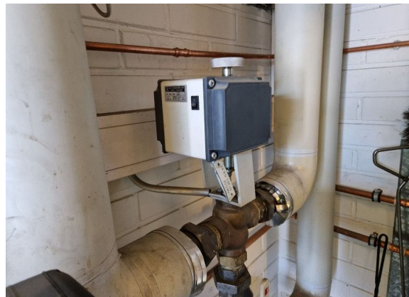
Kuva 76. Lämmityksen sekoitusventtiili ja toimilaite.
