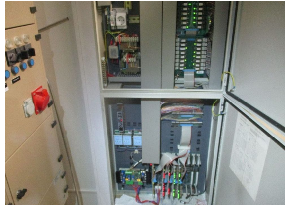
Kuva 175. VAK automaatiokeskus, IV-tilassa.
