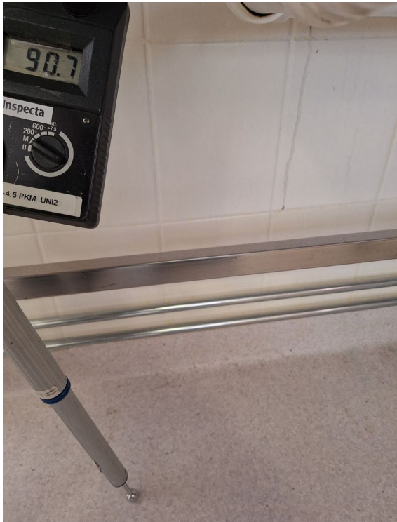
Kuva 7. Kohonneita pintakosteuspitoisuuksia lattialaatassa.
