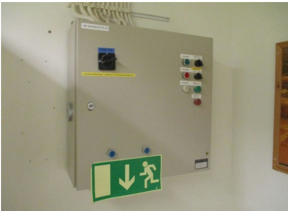
Kuva 120. Ohjauskeskus puutyötilan valvontahuoneessa.
