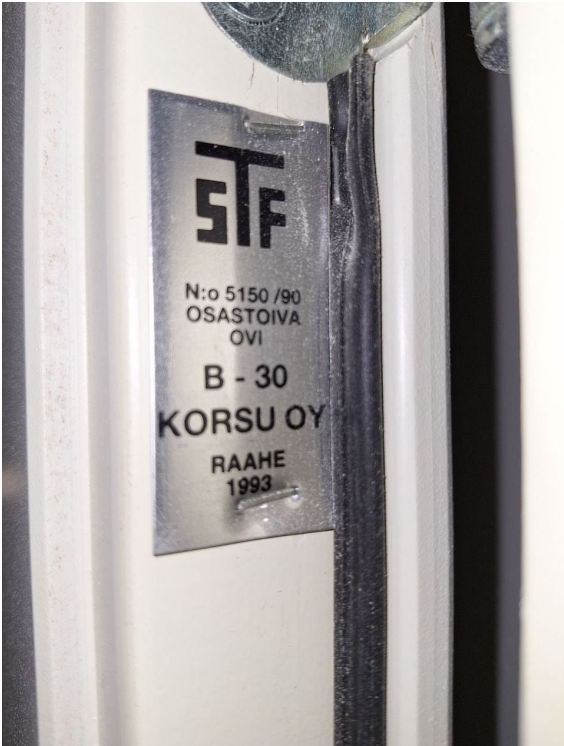
Kuva 51. Uusittu IV-konehuoneen osastoiva palo-ovi
