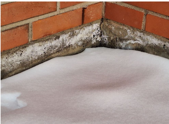
Kuva 6. Sokkelissa on kosteusrasitusjälkiä.
