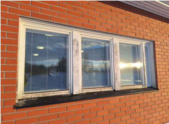
Kuva 20. Hilseilyä ikkunoiden puuosissa.
