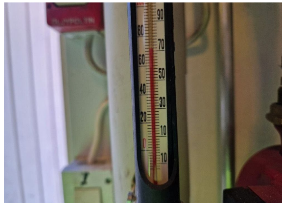
Kuva 78. Käyttöveden kierron lämpömittari.
