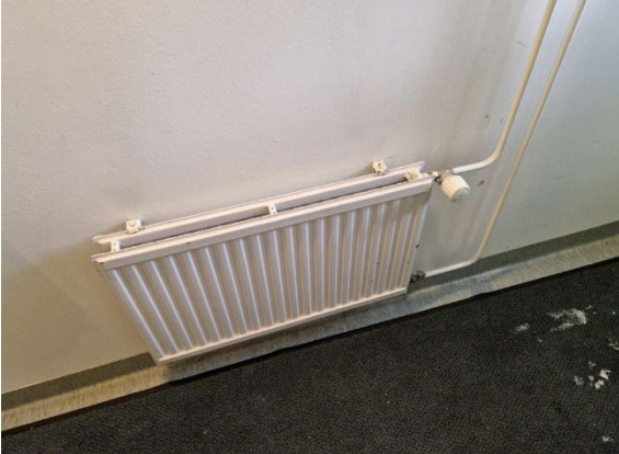
Kuva 82. Patteri, Danfos patteriventtiili ja -termostaatti (vv. 2003-2011).
