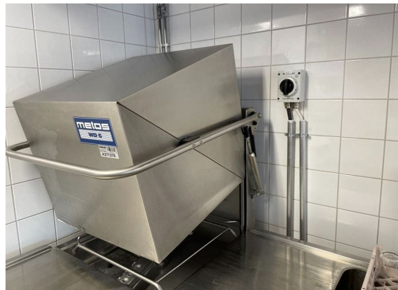
Kuva 123. Keittiökoje sähköistyksiä (uusittu 2021).
