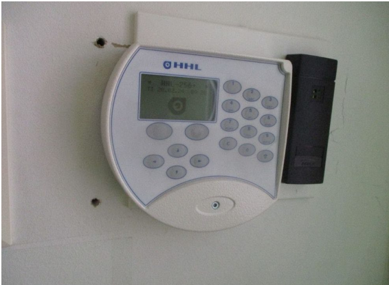
Kuva 167. Näppäimistö ja kulunvalvontalaite tuulikaapissa.
