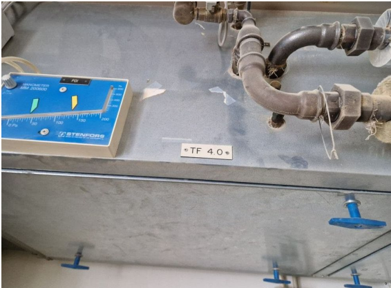
Kuva 96. Tuloilmakone TF 4.0 tekninen työ.
