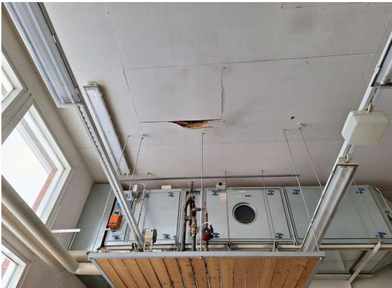
Kuva 67. Puutyötilan/maalauososan IV-konehuoneen pintarakenteita. Kattolevytyksessä on vikoja.
