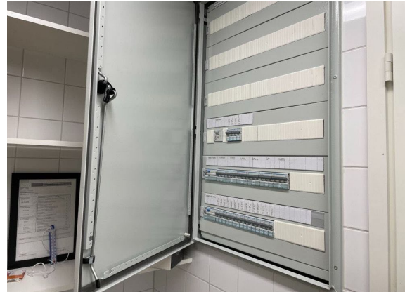
Kuva 117. Talouskeittiön uusittu keskus.
