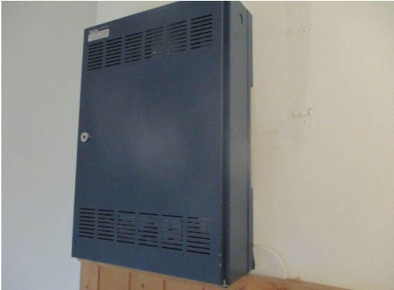
Kuva 155. Antennivahvistinkaappi portaikossa, ei päästy näkemään sisältä, lukittu.
