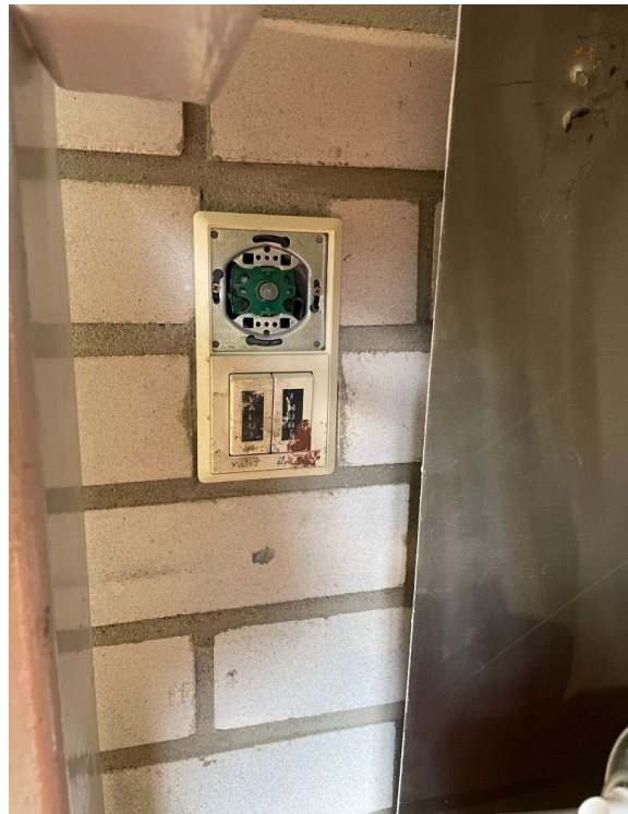
Kuva 131. Maalaamon kytkinkalusteen peitelevy oli pois paikoiltaan.
