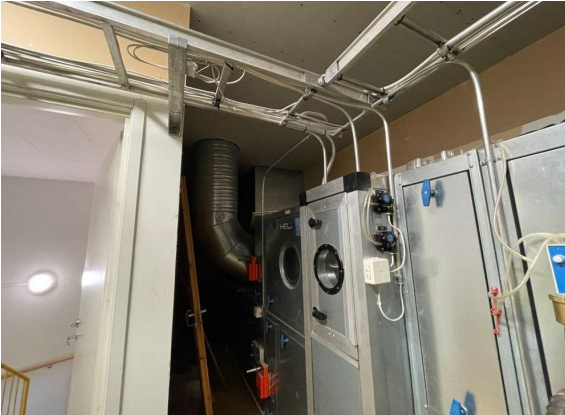
Kuva 110. IV-tilan kaapelihylly näkymää.
