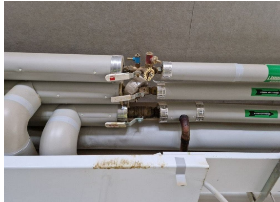
Kuva 88. Käyttövesiputkistoa, linjasäätö- ja sulkuventtiili sekä eristyksiä.
