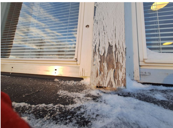
Kuva 18. Hilseilyä ikkunoiden puuosissa.
