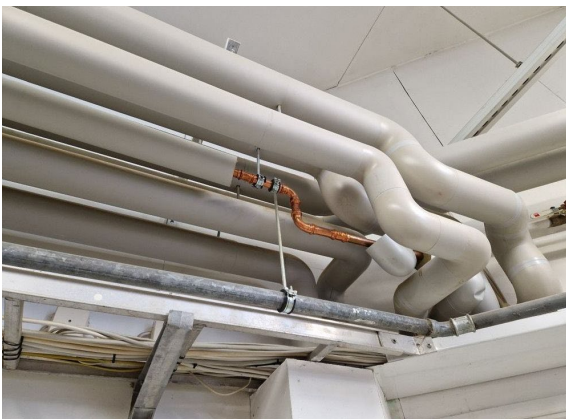
Kuva 89. Uusittua vesijohtoa, eristykset puuttuvat.
