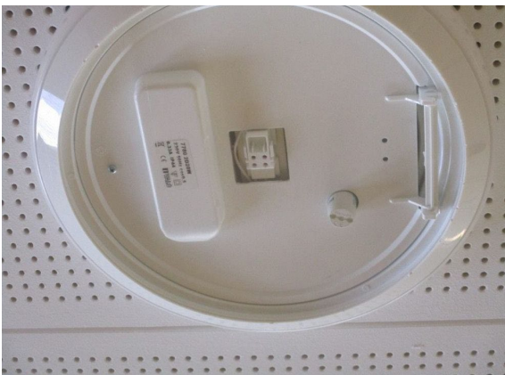
Kuva 136. Ryhmätilasta puuttui suojakupu ja lamppu.
