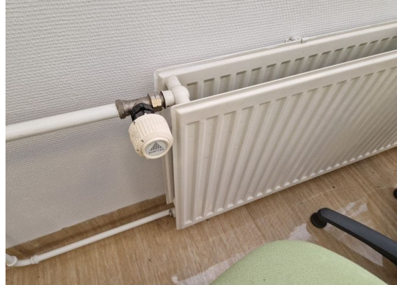
Kuva 83. Patteri, Danfos patteriventtiili ja -termostaatti (vv. 1994-2003).
