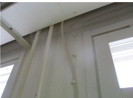
Kuva 114. Kaapeleita irti kiinnityksistä (puutyö/ verstautila).
