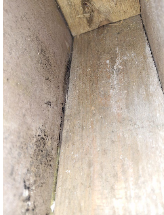
Kuva 11. Seinän sisäpuolisissa rakenteissa oli silmämääräistä runsasta mikrobikasvustoa ja kosteusrasitusjälkiä.
