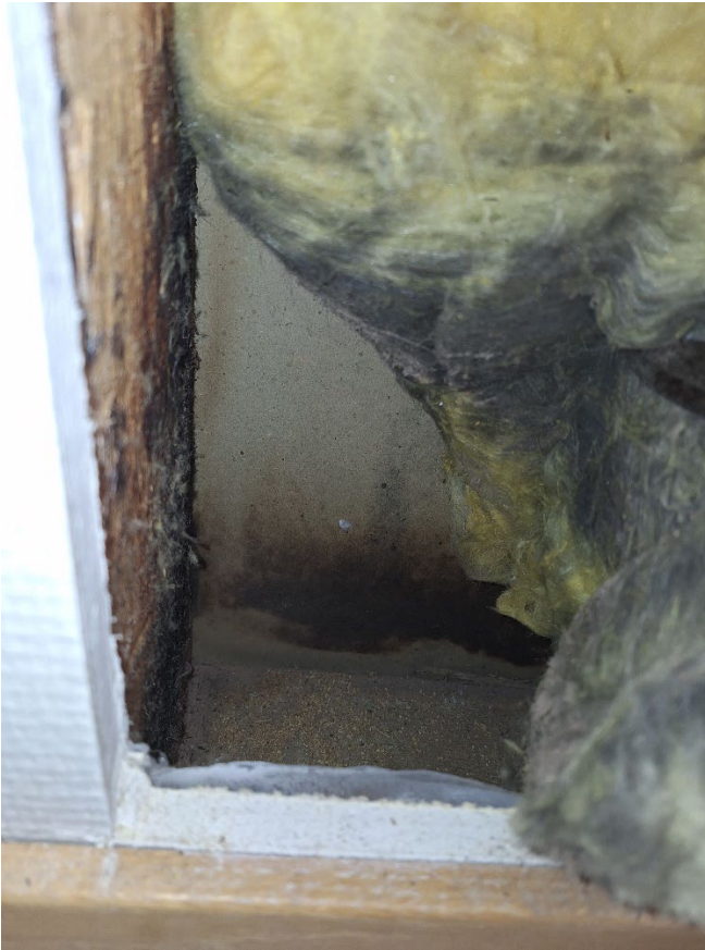
Kuva 18. Rakenteissa on ilmapuotojälkiä (noki- ja pölykertymä).
