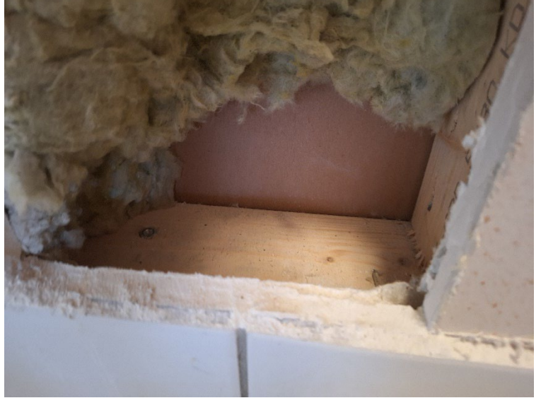
Kuva 15. Seinän sisäpuolisissa rakenteissa ei havaittu silmämääräisesti kosteusrasitusjälkiä mutta materiaalit ovat mikrobivaurioituneet.
