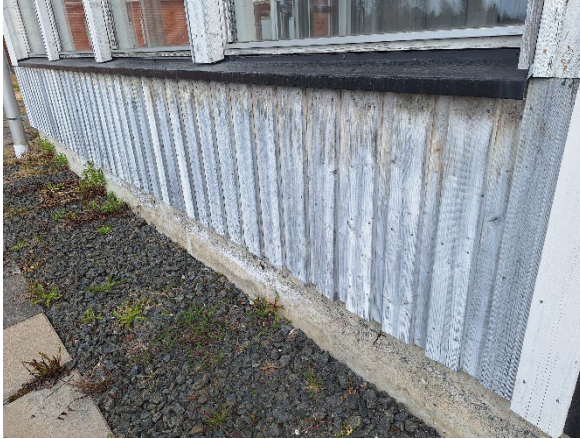
Kuva 5. Lumen seinustalle kasautumisen aiheuttamaa haristumaa laudoituksessa ruokalan ulkoseinällä.
