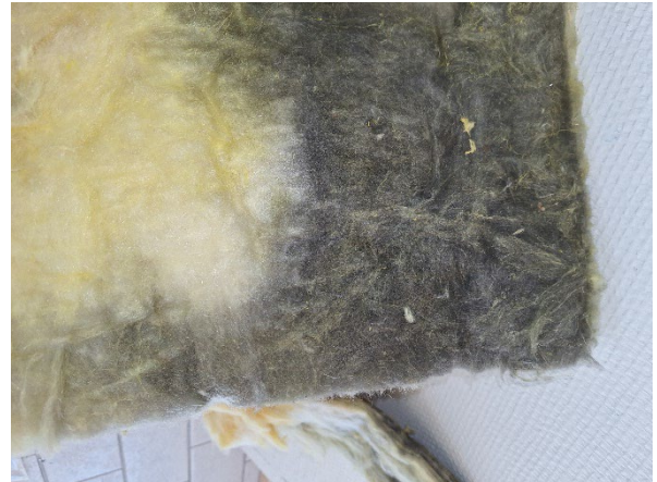
Kuva 19. Rakenteissa on ilmapuotojälkiä (noki- ja pölykertymä).
