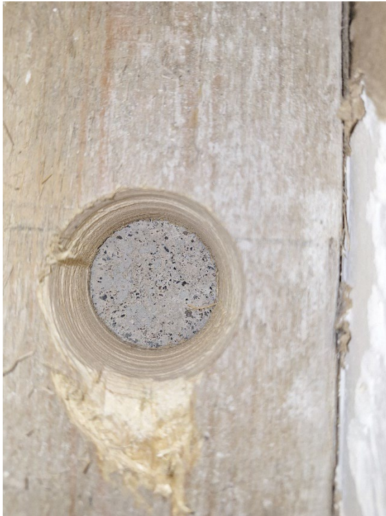
Kuva 12. Alaohjauspuun ja betonilaatan välissä ei ole kosteuskatkoa.
