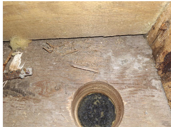
Kuva 17. Seinän sisäpuolisissa rakenteissa havaittiin silmämääräistä viitettä kosteusrasituksesta.
