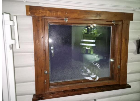
Kuva 36. Alkuperäisten ikkunoiden sisäpuoliset osat olivat siistikuntoiset. Ikkunoiden välisissä puuosissa havaittiin merkkejä kosteudesta.
