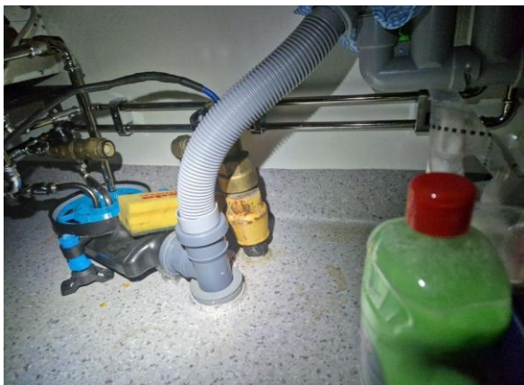
Kuva 73. Päärakennuksen allaskaapin viemärintiä.
