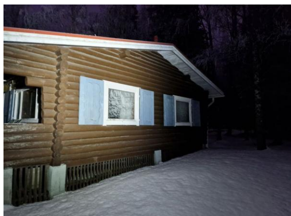
Kuva 30. Julkisivujen pinnat päämökissä olivat siistissä kunnossa. Räystään laudoituksessa paikoin tummentumaa ja huoltotoimenpiteet ovat ajankohtaisia.
