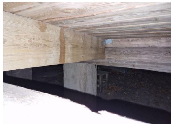
Kuva 23. Päämökin terassin kohdalla merkkejä kosteusrasituksesta, mikä johtuu mitä ilmeisimmin terassille kulkeutuvasta vedestä. Pitkäaikainen kosteusrasitus voi vaurioittaa rakenteita.
