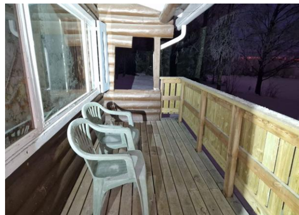
Kuva 15. Päämökin terassilaudoitus päällisin puolin siistikuntoinen, mutta uusimiseen on syytä varautua 10 vuoden jaksolla.
