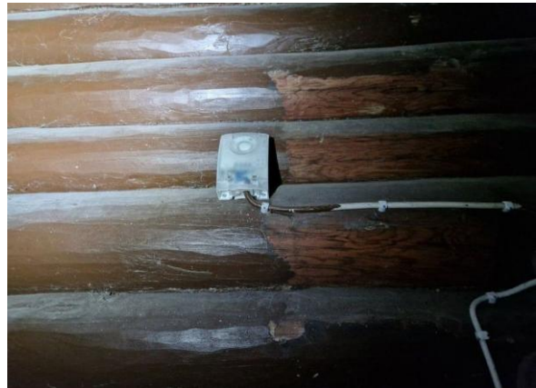
Kuva 119. Hämäräkytkin päärakennuksen ulkoseinustalla.
