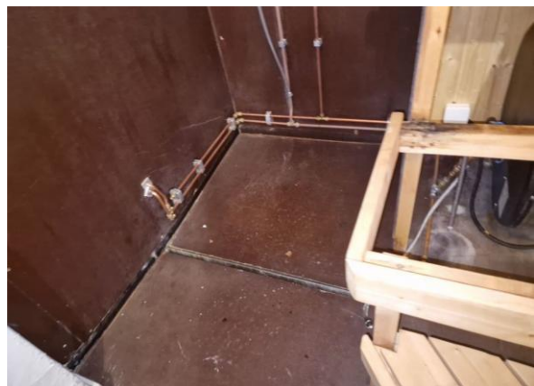
Kuva 69. Vedenpoisto saunasta sekä suihkun alueelta toteutettu levyjen väliin tehdyllä raolla. Veden ohjauksesta ei ole varmuutta (ei päästy havainnoimaan lumitilanteesta johtuen).
