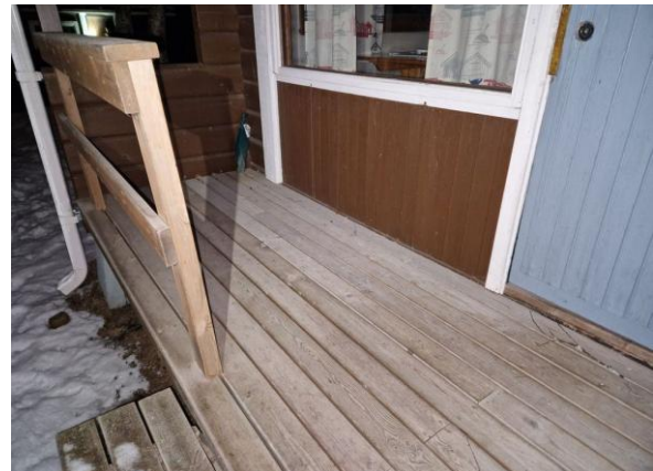
Kuva 13. Saunamökin terassin laudoitus huoltokäsittelyn tarpeessa, muutoin vielä hyväkuntoinen.
