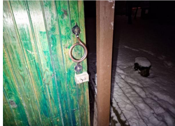
Kuva 45. Saunamökin tuvan oven maalipinta on huollon tarpeessa. Lukitusjärjestelmä vanhanaikainen.
