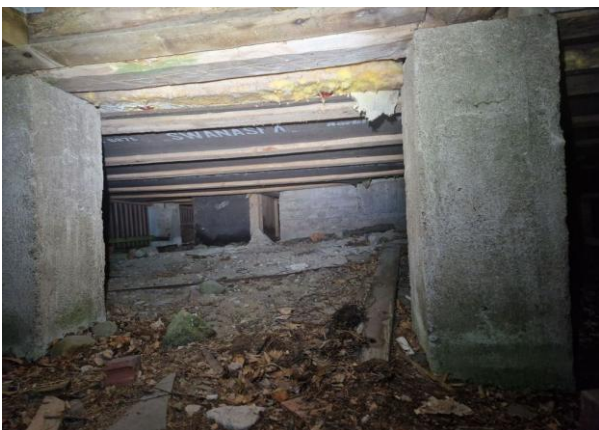
Kuva 22. Alapohjan eristeitä paikoin näkössä. Levytys osin jäänyt vajaaksi ja roskaa alapohjan tuuletustilassa.
