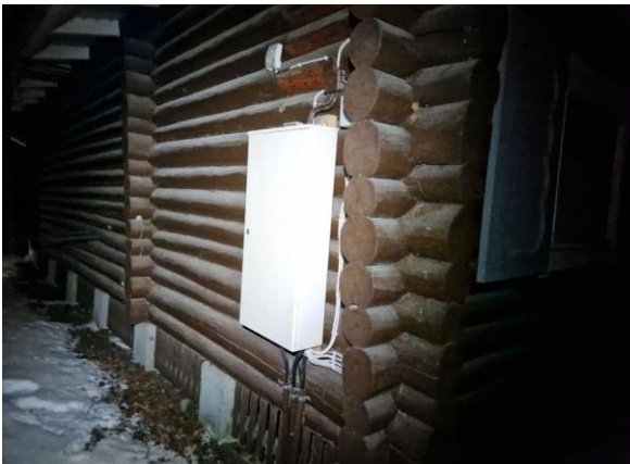
Kuva 91. Pääkeskus näkymää ulkoseinustalla.
