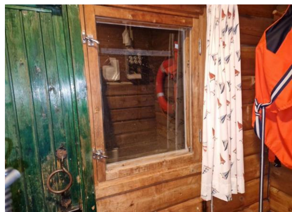
Kuva 40. Saunamökkin ikkunoissa merkkejä kosteudelle altistumisesta.
