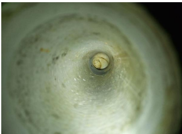
Kuva 75. Saunamökin pesualtaan viemärintiä.
