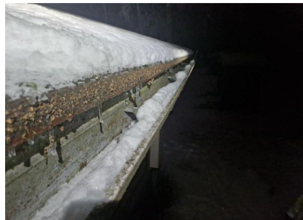
Kuva 48. Vesikatteenä peltikate, katteessa reuna alueilla runsaasti sammalkasvustoa, jonka puhdistamista suositellaan vesikatteen kunnossa pysymisen edistämiseksi.
