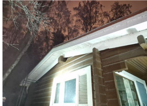
Kuva 34. Räystääiden alapuolen ja otsalauoituksissa huoltomaalauksen tarve.
