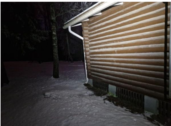
Kuva 18. Vesi ohjautuu syöksytorvista maaperään, suositellaan vedenohjauksen parantamista kauemmas rakennuksesta.
