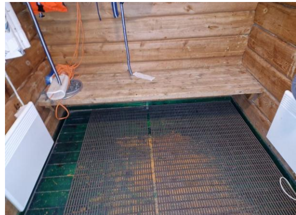
Kuva 63. Pukuhuonetilassa lattiassa pintakäsitelty laualattia. Lattiassa kosteuden ja käytön aiheuttamaa kulumaa.
