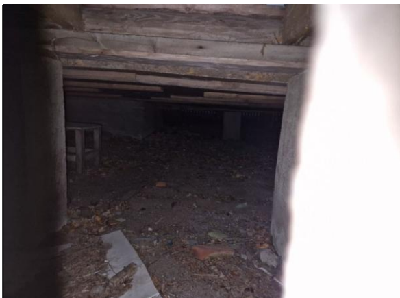
Kuva 21. Päämökin alapohja on siistissä kunnossa. Mökin betoniperustukset päällisin puolin siistit. Takan kohdalla betonijalka.
