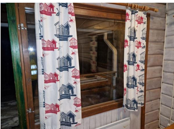
Kuva 39. Saunamökkin ikkunoissa käytön ja iän aiheuttamaa kulumaa.
