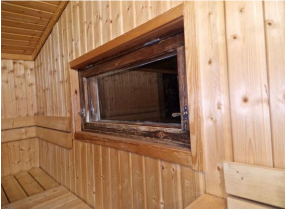
Kuva 41. Saunan ikkunan puuosat kunnostuksen tarpeessa.
