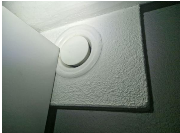
Kuva 88. Päärakennuksen painovoimaisen ilmanvaihdon poistoventtiili.
