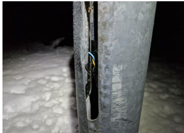
Kuva 109. Pylväsvalaisimen kotelo rikki/ vääntynyt.
