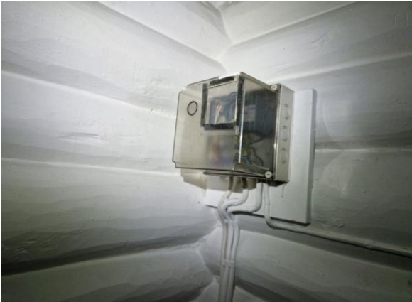
Kuva 93. Päämökkin sisällä oleva releketelo (ohjauskontaktori).
