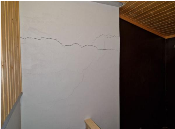
Kuva 66. Saunan puolella muurauksessa halkeama ja pintavaurioita. Tilassa sähkökiuas.
