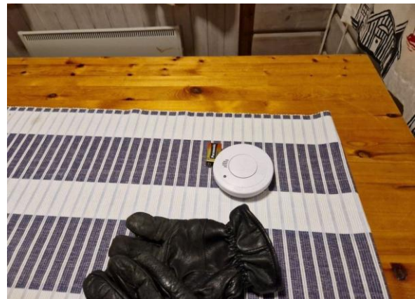
Kuva 117. Palovaroitin saunarakennuksen pöydällä irrallaan.
