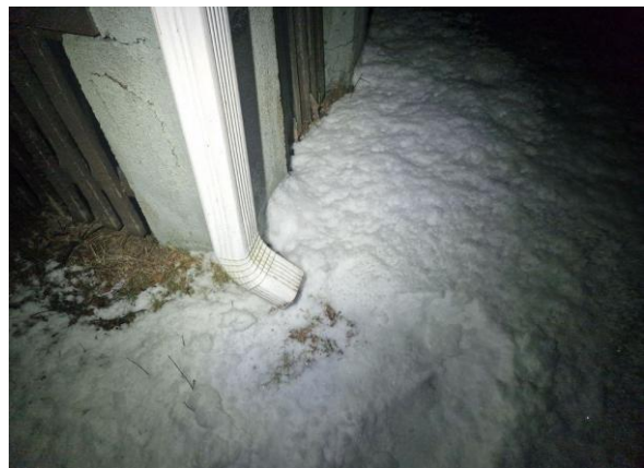
Kuva 19. Syöksytorvet ohjautuvat suoraan maahan, veden ohjausta rakennuksen perustuksien vierustoilta tulisi parantaa.
