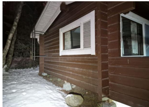
Kuva 38. Saunamökkin ikkunoiden puuosat altistuneet kosteudelle.
