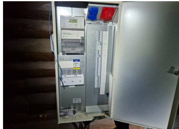
Kuva 92. Uusittu pääkeskus 2020 (päämökin takaseinustalla).
