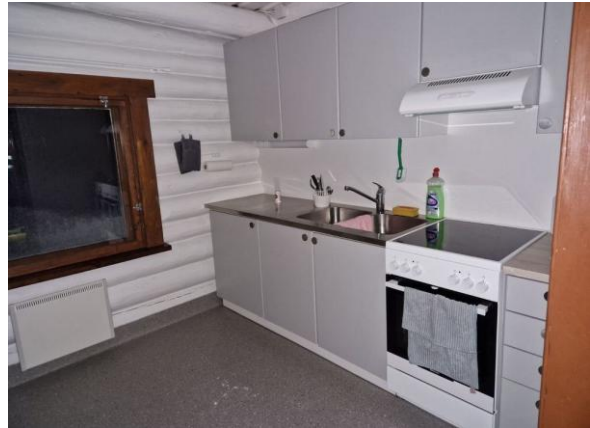
Kuva 71. Päämökin uusitut keittiökalusteet ja kodinkoneet ovat siistikuntoiset.
