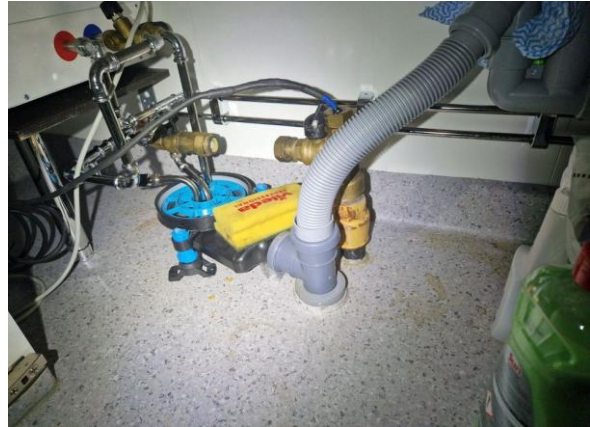
Kuva 81. Uusittuja käyttövesijohtoja, mahdollinen vesimittari puuttuu. Mahdollinen tonttivesijohto.
