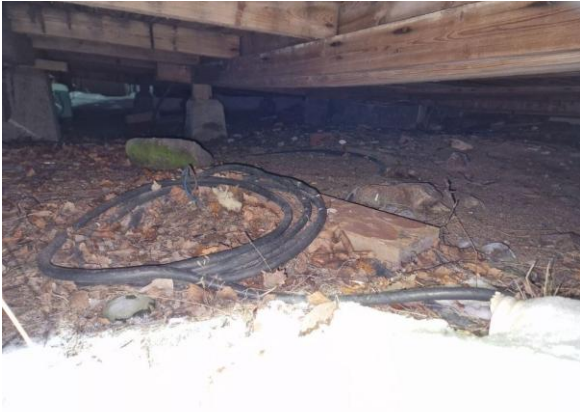
Kuva 24. Saunamökin alapohja on rossipohjarakenne. Alapohjassa jonkin verran roskia. Alapohjan puuosissa paikoin merkkejä kosteudesta, mikä johtuu mitä ilmeisimmin saunaosalta tulevasta kosteudesta.
