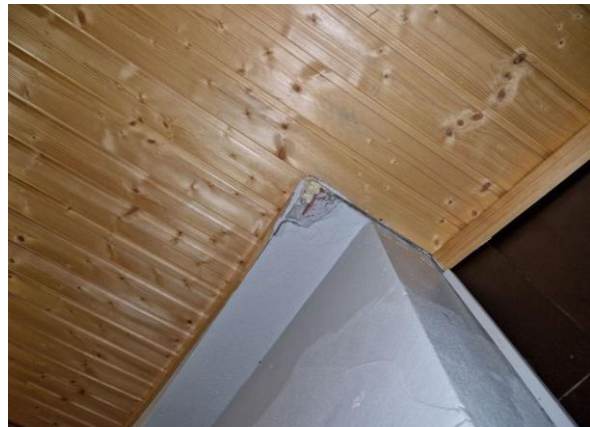
Kuva 67. Saunan puolella yläosassa muurauksesta lohjennut palainen.
